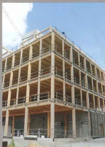
Perspective du Groupe Pichet à Bordeaux : le bâtiment tertiaire à ossature bois en construction le plus élevé de France.
