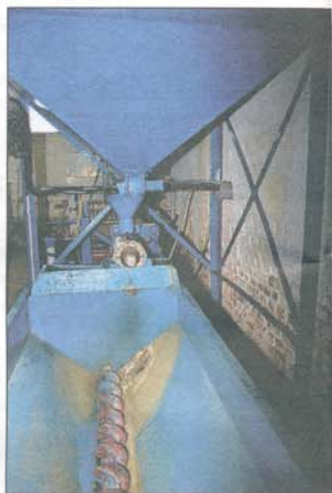
Vue de la trémie d'attente qui réceptionne les tourteaux avant de les envoyer, après refroidissement, vers le stockage en bigs bags.
